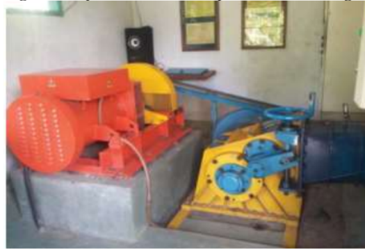
Gambar1. Generator dan Turbin Pembangkit Seloliman
